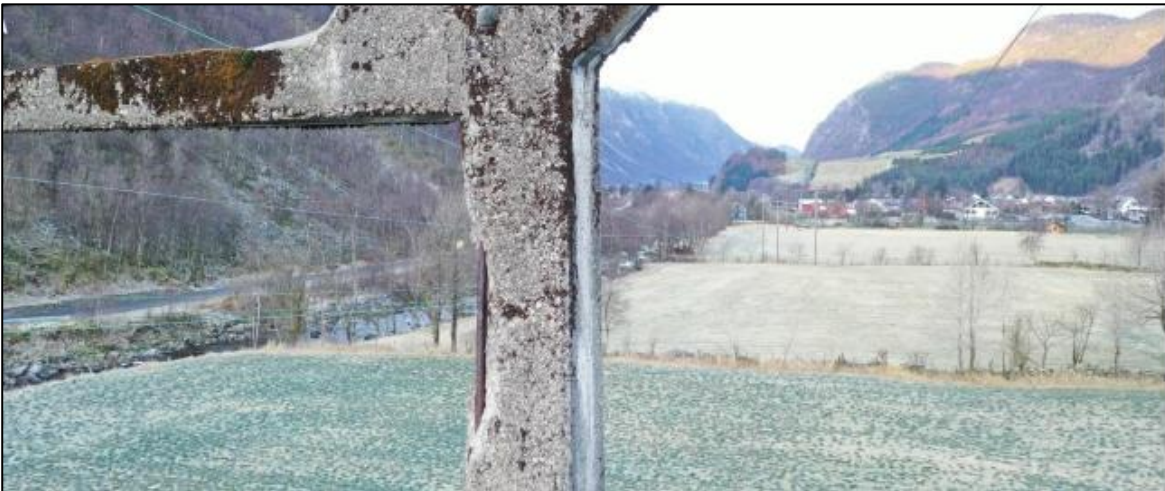
Figur 5 Maudal–Oltedal M74, øvre del av masta der betongen er forvitret og armeringsjern kommer frem
