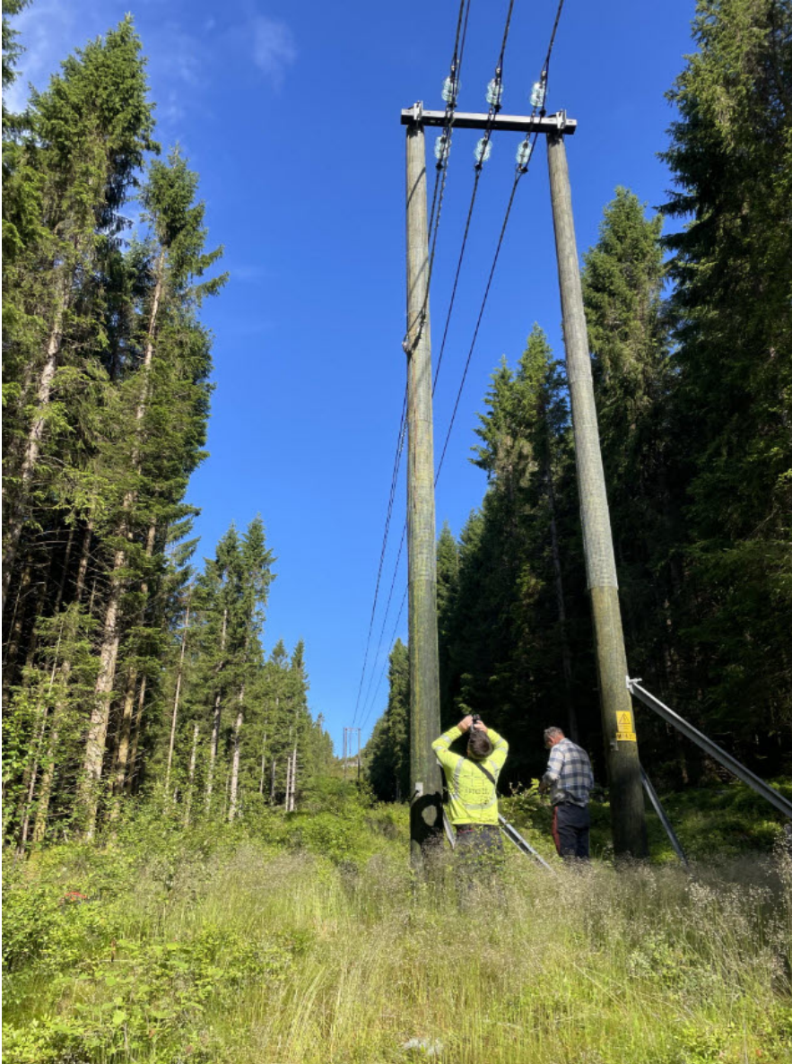
Figur 4: Eksempel på en 22 kV ledning som Lnett har bygget i Ryfylke. Kilde: E-post fra Børre Dybesland i Lnett, 2. desember 2024.
