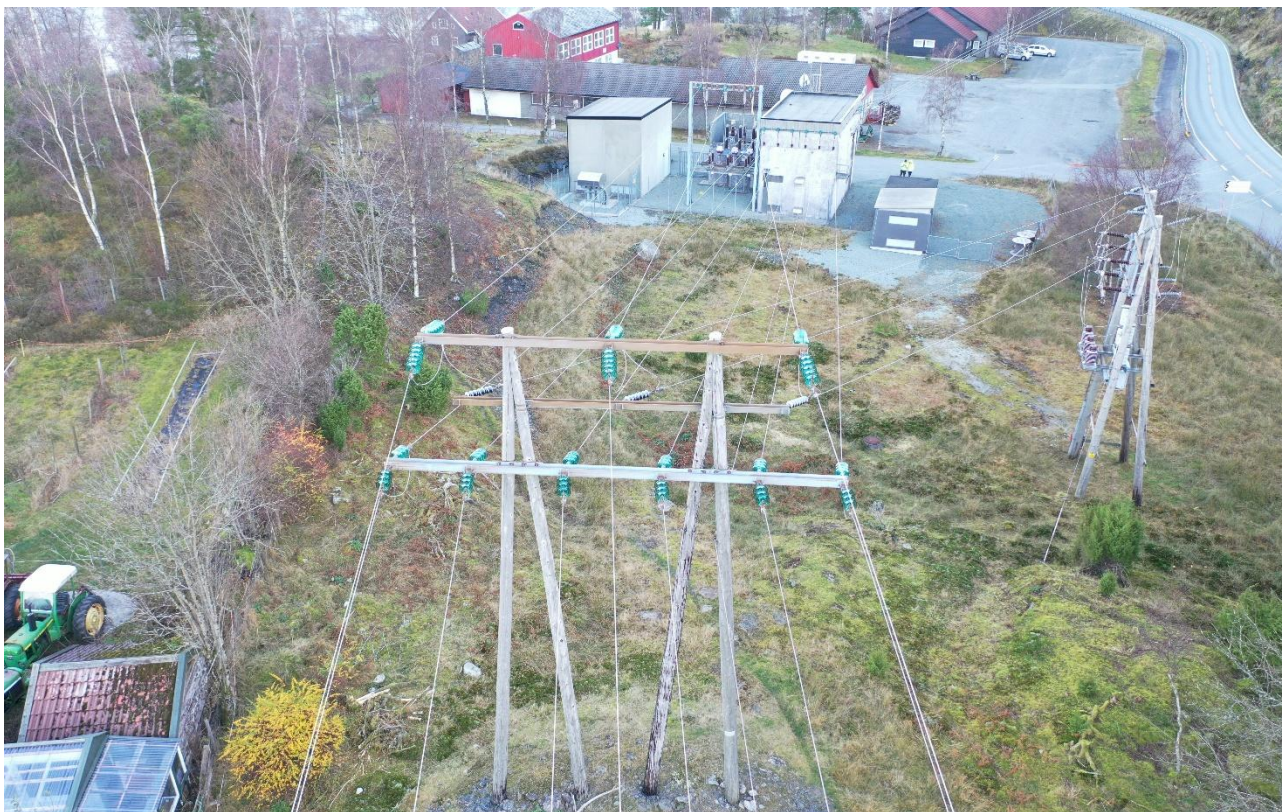
Figur 1 Bilde fra Gamle Hjelmeland transformatorstasjon, der ledning mot Hjelmeland kraftverk går ut til høyre
