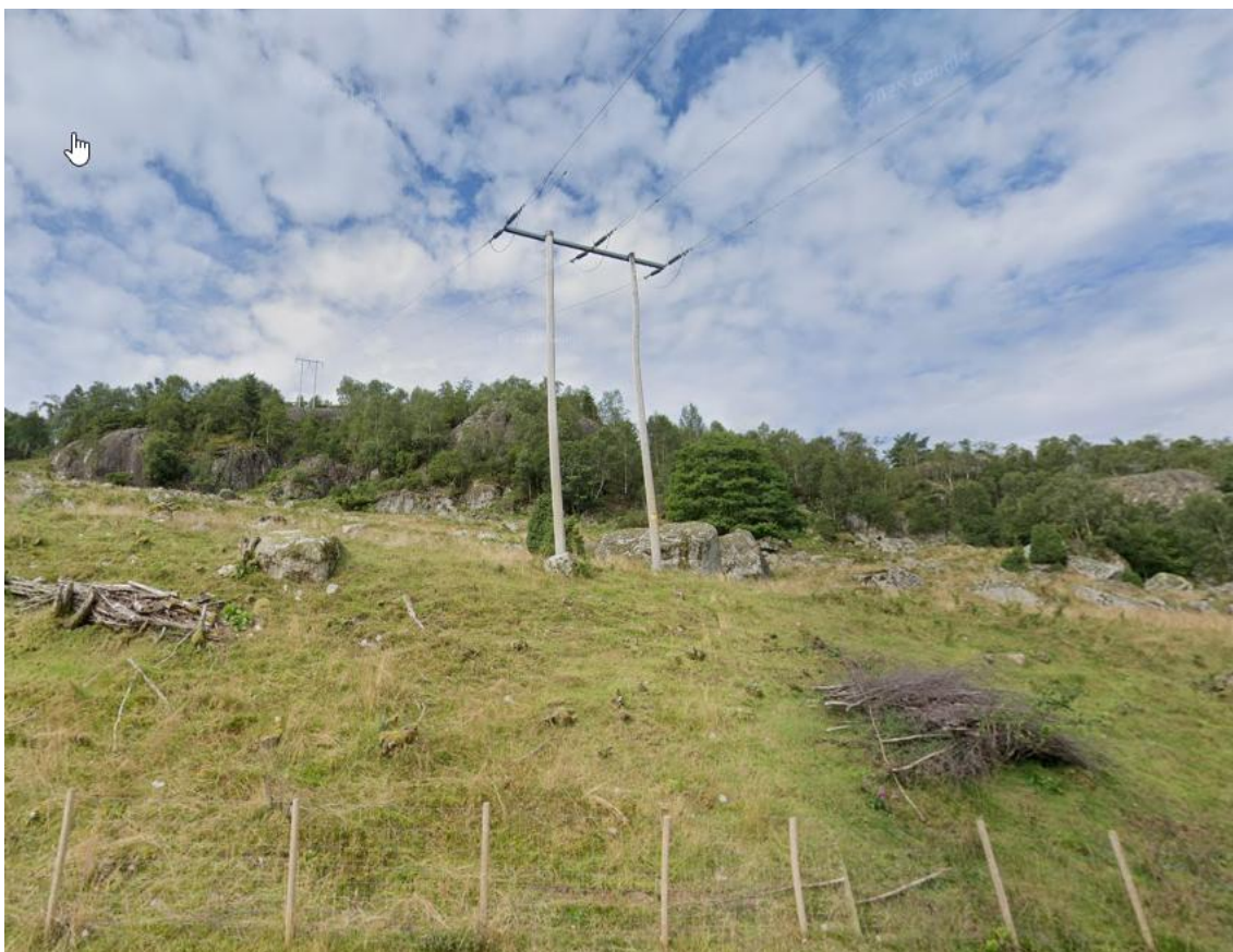
Figur 3 Bilde av mast 48 ved Vormedalsvegen (hentet fra Google Maps)
