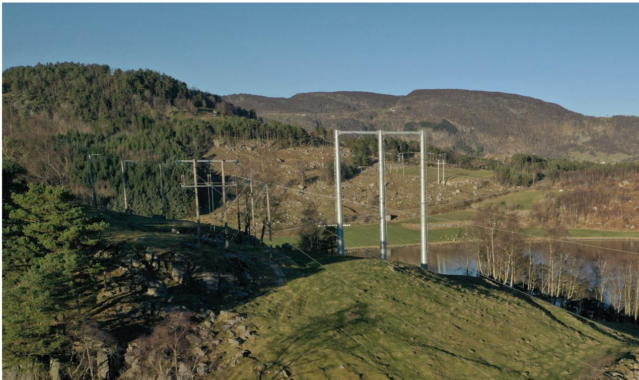
Figur 5 Bilde fra Nilsahammaren, sett fra syd. Stålmasten er for 132 kV Veland-Hjelmeland. Til venstre for den står mast 69 fremst, mast 70 (spennbukker) bak til venstre og første mast mot Årdal bak til høyre
