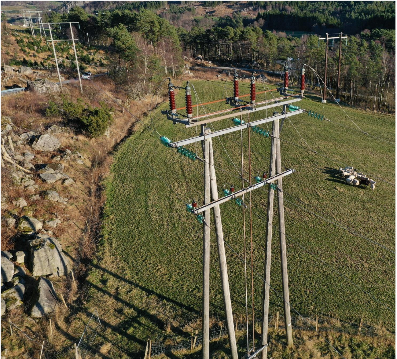
Figur 1 Mast 72 med mast 73 m.fl. bak til venstre og mast i 132 kV Veland–Hjelmeland bak til høyre
